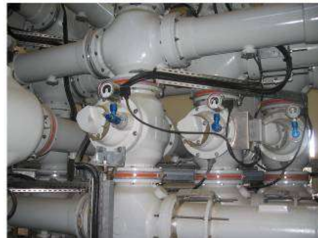
КРУ с газовой изоляцияй
