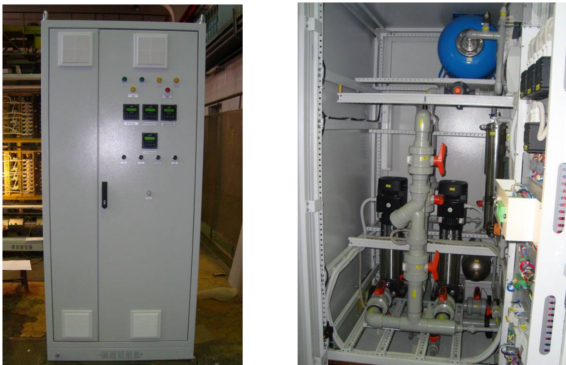
Рис.8. Система охлаждения: внешний вид и вид с открытыми передними дверями.
