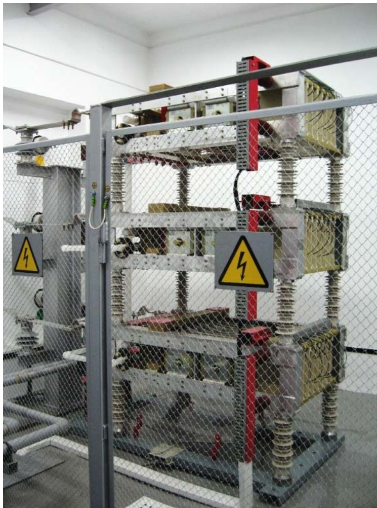
Рис. 2. Высоковольтный тиристорный вентиль
