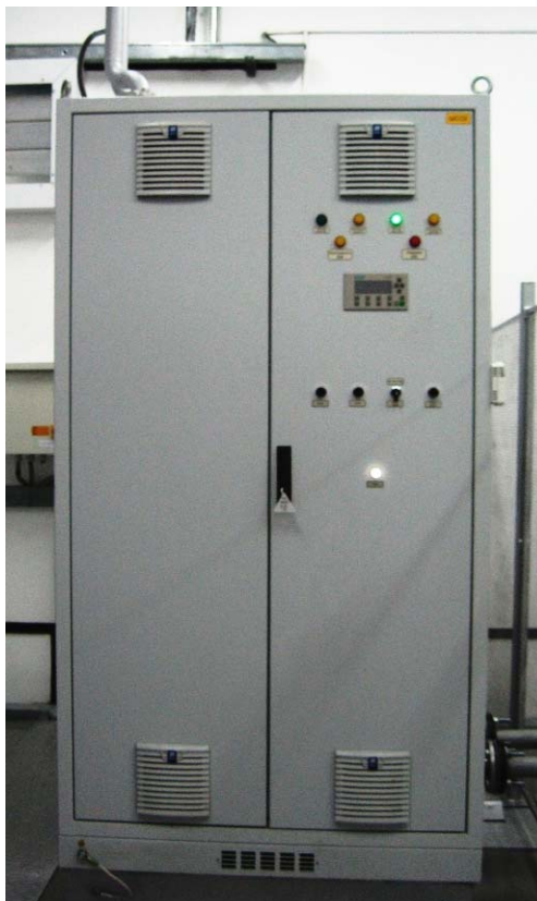
Рис. 6. Шкаф системы охлаждения
