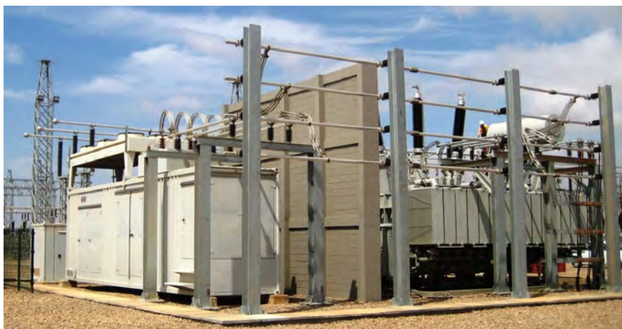
Рис. 8. Установка УШРТ 220 кВ 60 МВА на ПС Viana (Ангола)
