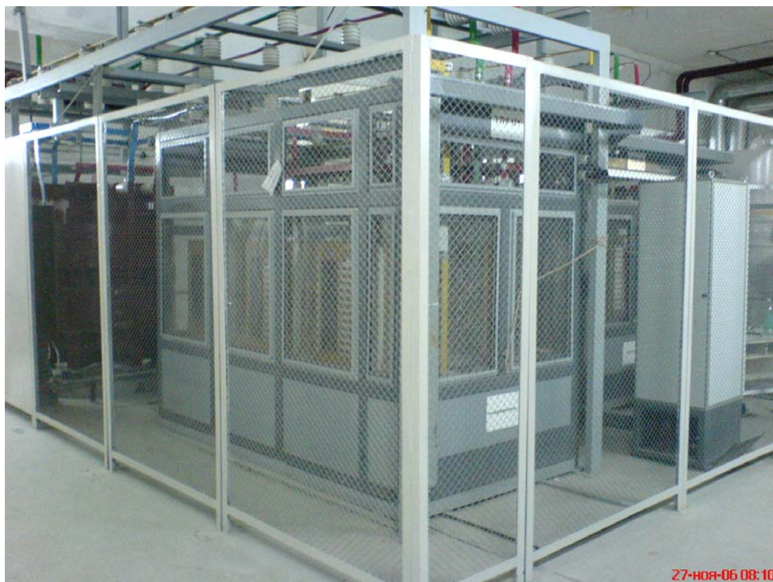
Рис. 2. Тиристорное пусковое устройство на объекте
